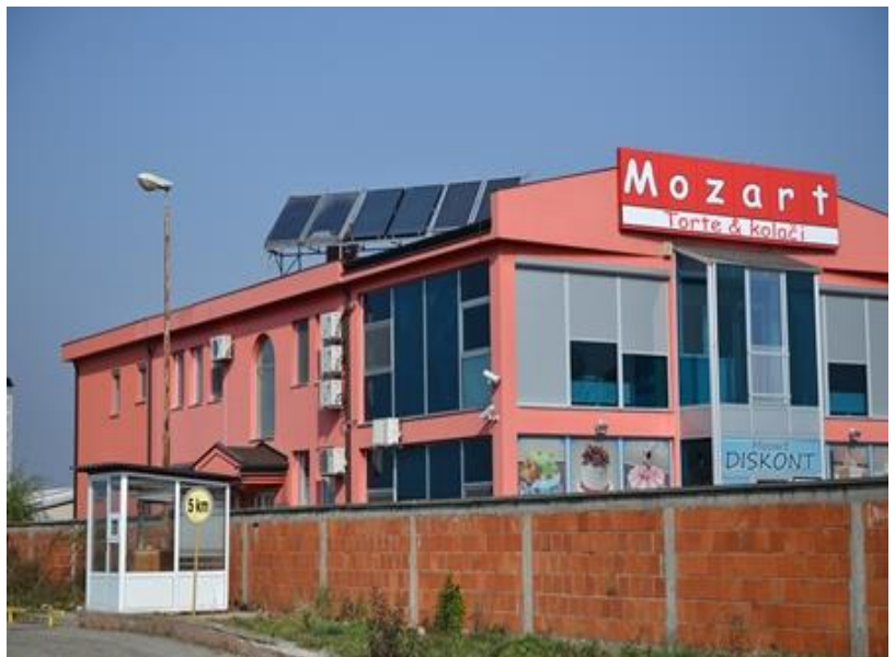
Slika: Solarni kolektori u Bijeljini
